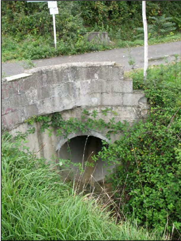
Comparto n°9 foto 1: particolare del tombamento del corso principale al di sotto della Via Capilato (diametro 100 cm)
