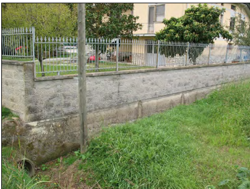
Scheda 1 foto 3: inizio della tubazione che si innesta all'interno del tombamento principale a monte della Via di Lungomonte.
